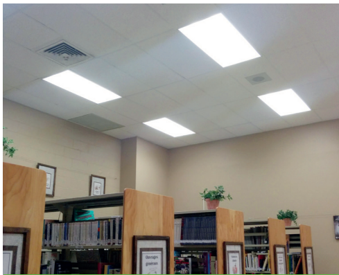
École secondaire La Concorde : Éclairage
